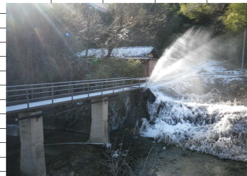
2022/1/22 毛賀水管橋φ100漏水
