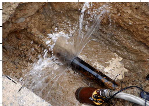
2021/5/24 上郷北条配水管φ100漏水
