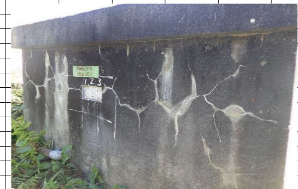
天竜峡配水池 (撮影R2劣化度調査より) ※切欠は中性化試験による
