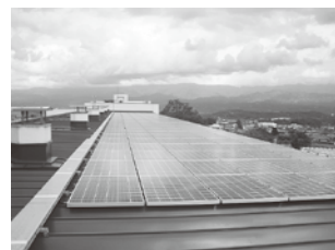
旭ヶ丘中学校に設置された太陽光パネル
