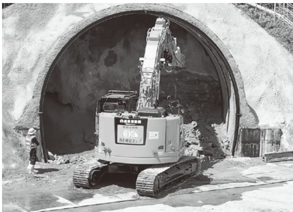
2021年9月から工用トンネルを掘削している 中央アルプストーンネル(松川)
