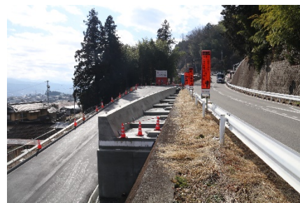
土曾川橋りょう右岸下部工工事 飯沼南地区の市道付替工事 市道五郎田線北側の新設交差点 工事を実施
