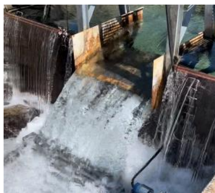
マイクロ水力発電機稼働状況（発電中）
