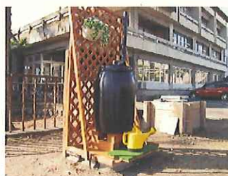
雨水タンク(左)、浸透ます(右)
