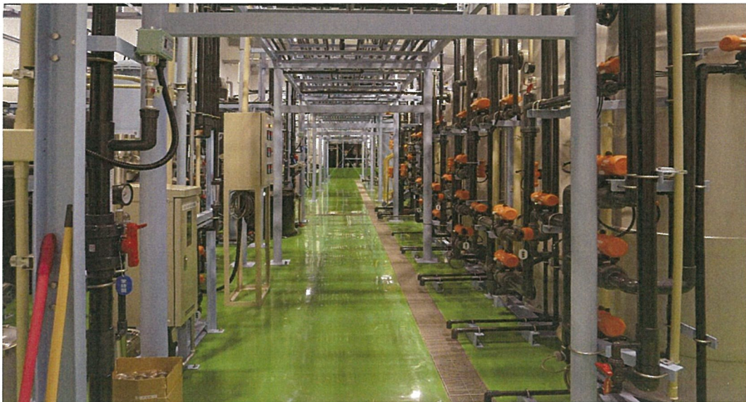
航空宇宙産業クラスター拠点工場表面処理工場棟内部
