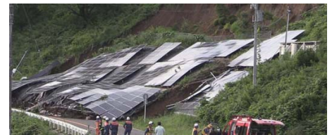
■大雨による土砂崩れで斜面に設置した施設が崩壊(仙台市)
