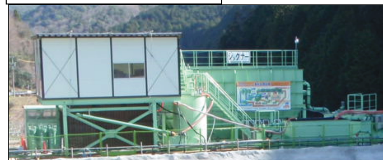
工事排水の処理設備
