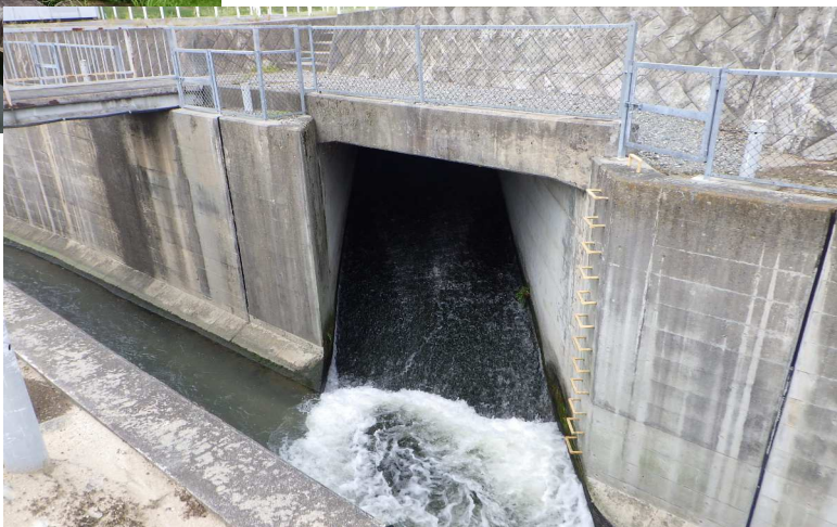
松尾浄化管理センター 汚水処理後放流水の放流渠
