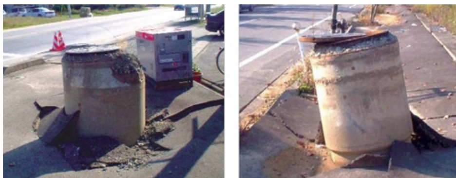
液状化によるマンホールの突出
