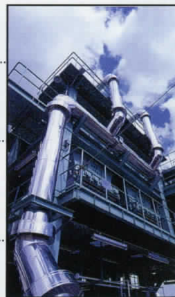
汚泥焼却施設
