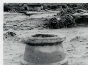
露出したマンホール（城東付近）
