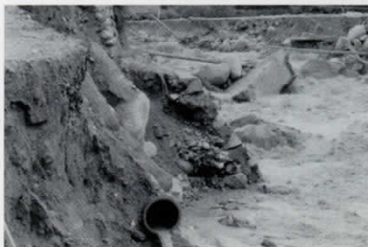
下水管の露出・断裂
