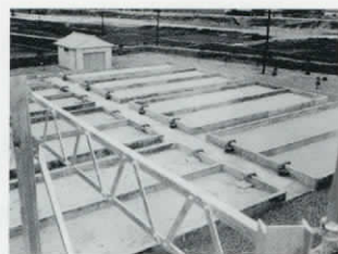
別府終末処理場の沈殿池設備
