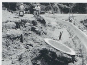
土砂で崩れたマンホール（水の手）
