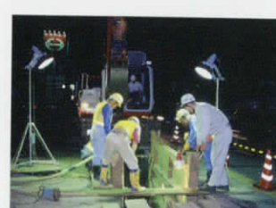
夜間工事風景：上郷飯沼
