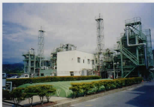
汚泥焼却炉 1号炉 (右側) 2号炉 (左側)
