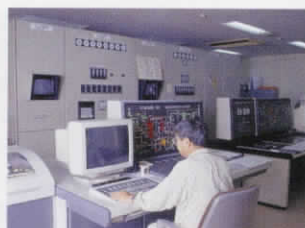
汚泥乾燥焼却炉の運転はコンピューターによって管理されています。
