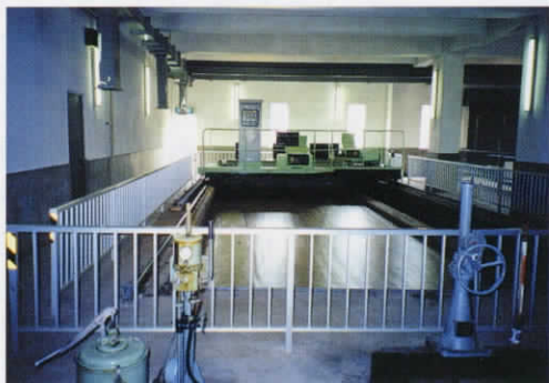
加圧浮上濃縮槽
