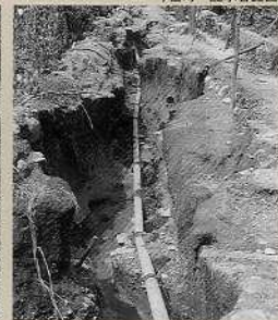
今宮町・配水管露出
