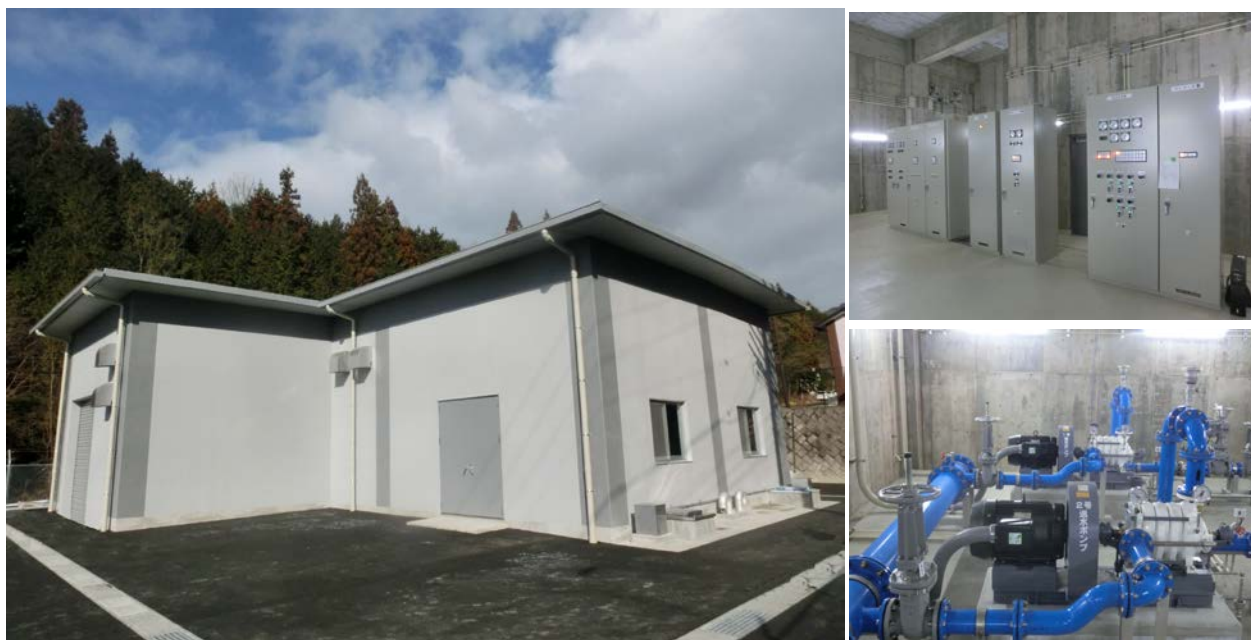
今宮中継ポンプ場の外観及び施設内部
