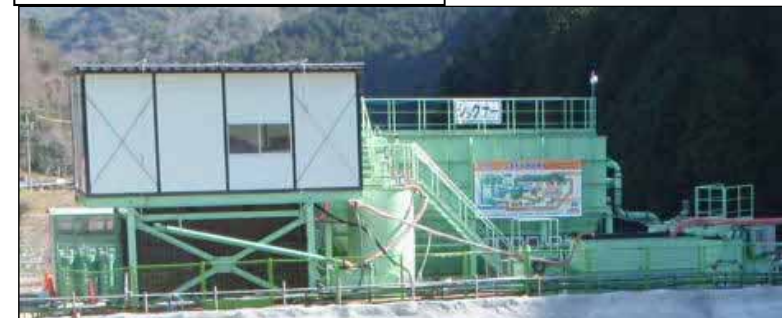
工事排水の処理設備
