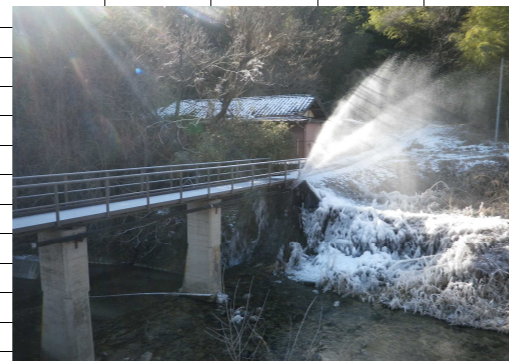
2022/1/22 毛賀水管橋φ100漏水
