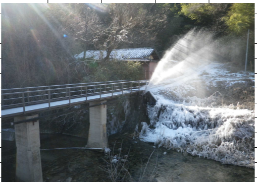
2022/1/22 毛賀水管橋φ100漏水
