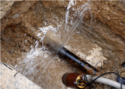
2021/5/24 上郷北条配水管φ100漏水
