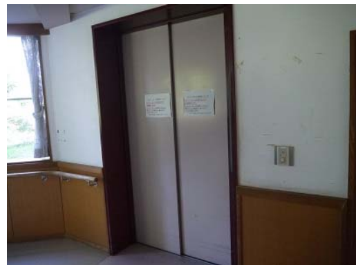
エレベーター
