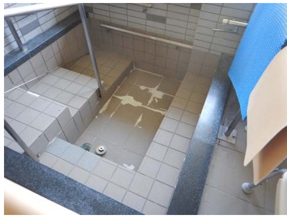
浴槽の劣化例
