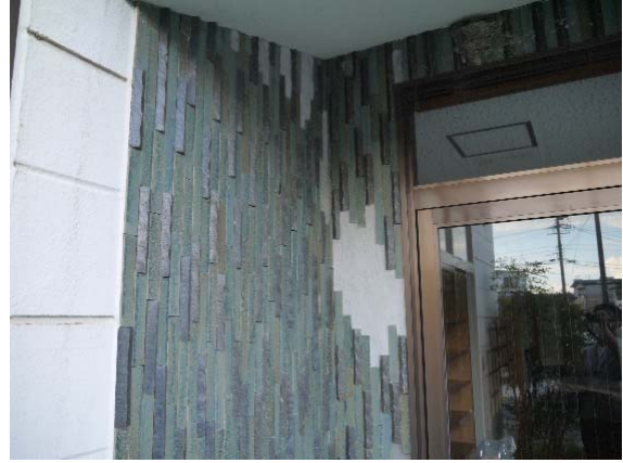
外壁の劣化例
