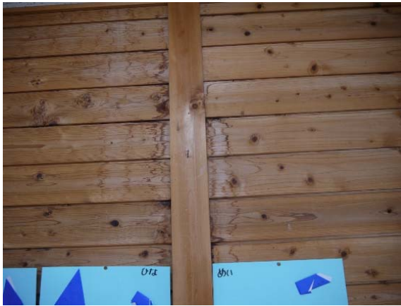
内壁の劣化例
