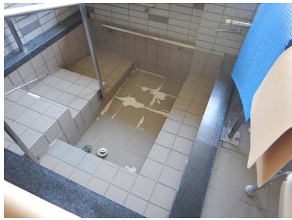
浴槽の劣化例
