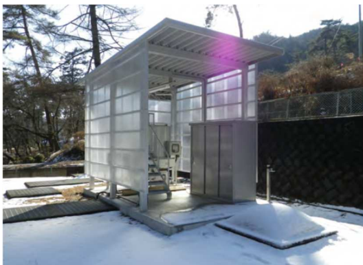
妙琴沈砂池上に設置した活性炭注入装置
