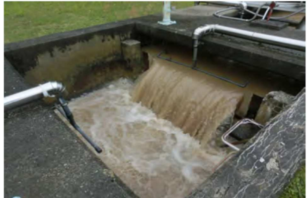
妙琴浄水場の着水井での原水
