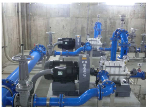
今宮中継ポンプ場の送水ポンプ （平成31年3月より稼働）
