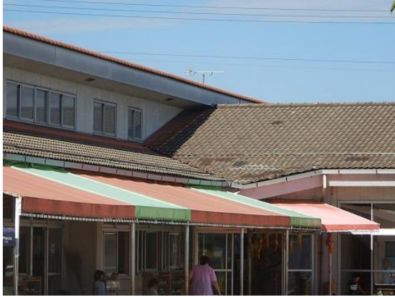
屋根面の劣化例
