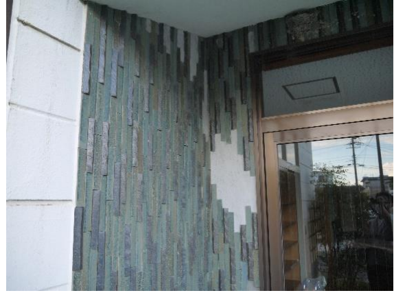
外壁の劣化例
