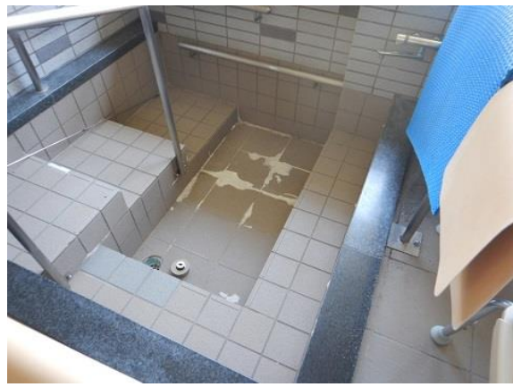
浴槽の劣化例
