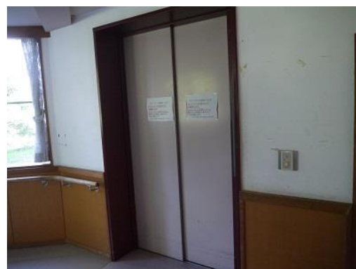
エレベーター
