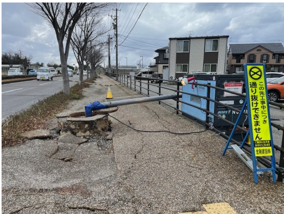
マンホール浮上による仮設配管状況
