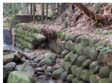
崩落した河川護岸
