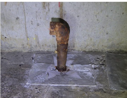
【ピット内配管の腐食】
