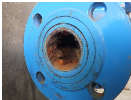
【温泉流量計の腐食】
