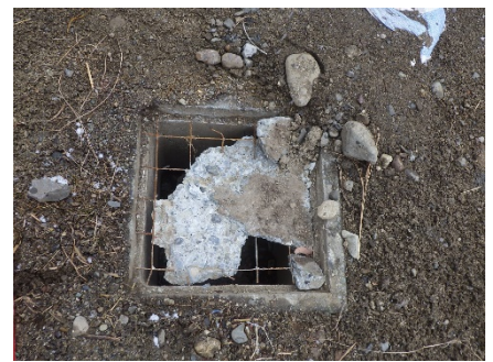
【雨水枡の破損】
