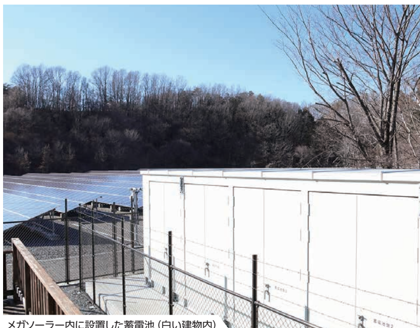
メガソーラー内に設置した蓄電池（白い建物内）
