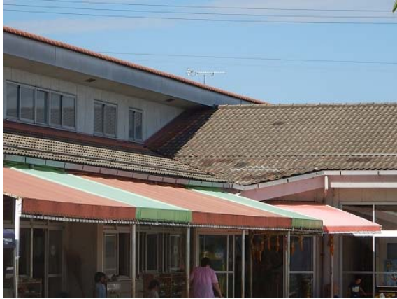
屋根面の劣化例
