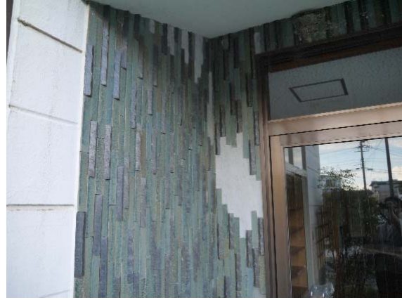
外壁の劣化例
