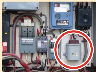
低圧分電盤内の低圧コンデンサー
