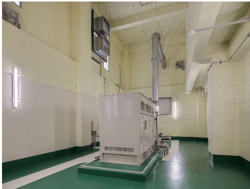
旧非常用発電機 (300KVA)
