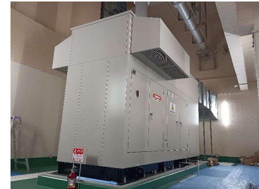
新非常用発電機 (500KVA)
