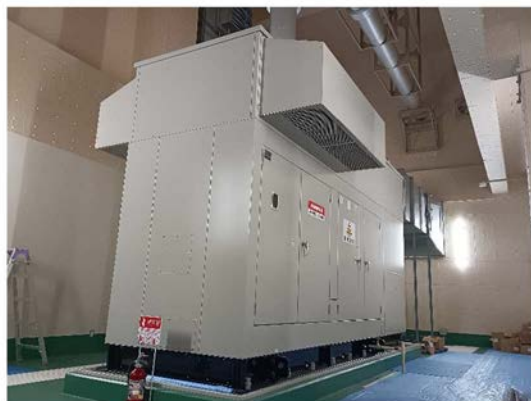
新非常用発電機（500KVA）
