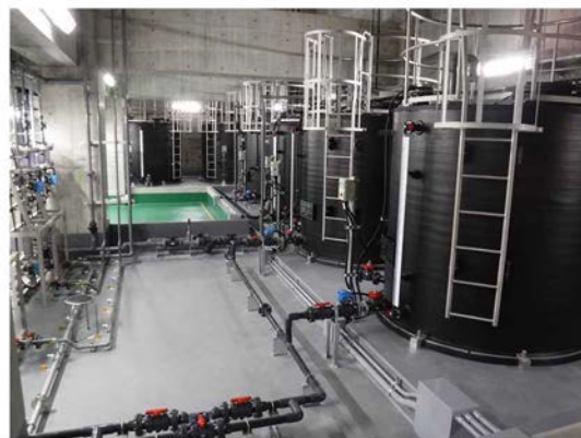
薬品貯蔵槽設置状況
