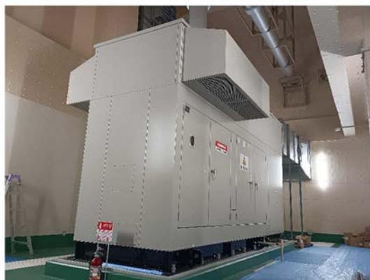
新非常用発電機（500KVA）
