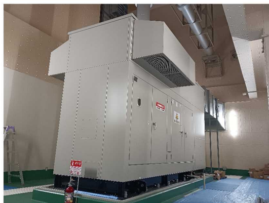
新非常用発電機（500KVA）
