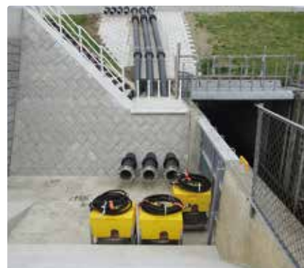
祝井沢川排水ポンプユニット(松尾)
