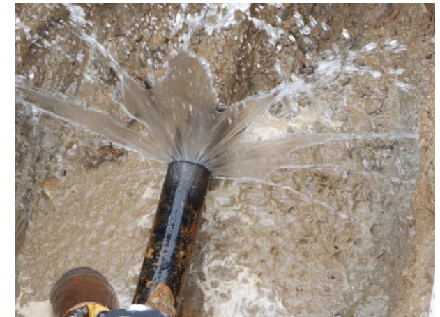
配水管での漏水
