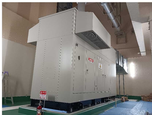
新非常用発電機（500KVA）
