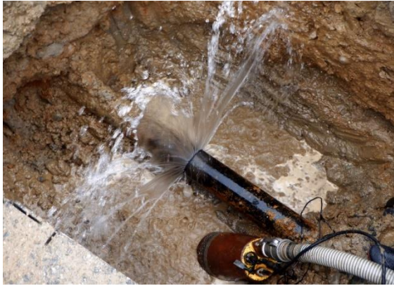
上郷北条 配水管φ100漏水
