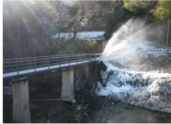
毛賀 水管橋φ100漏水
